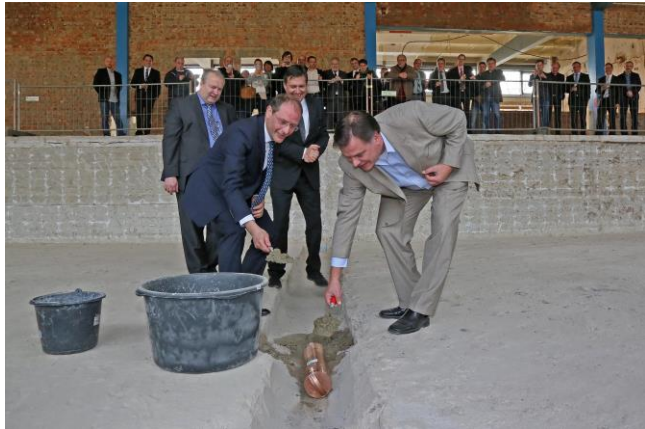
Michael Bartsch von der GIIZ, Sachsens Innenminister Markus Ulbig, Bert Hoffmann von der Firma Bauconcept und GIIZ-Chef Tobias Teich (von links) mauern eine Zeitkapsel in das ehemalige Schwimmbecken. (Foto: Ralph Köhler)
